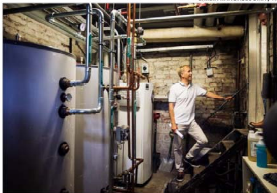
Jari Kajaks esittelee Kivelänkatu 1b:n maalämpöpumppujärjestelmän osia talon teknisissä tiloissa.
