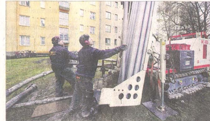
Petri ja Riku Häkkänen porasivat torstaina maalämmön reikiä töölöläisen kerrostaloyhtiön omalle pihalle.
